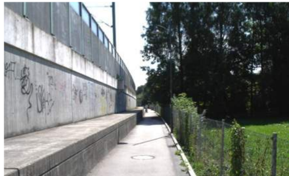
Abb. 39: Schwachpunkte des Wegenetzes in Mering, südlicher Bahnzugang
